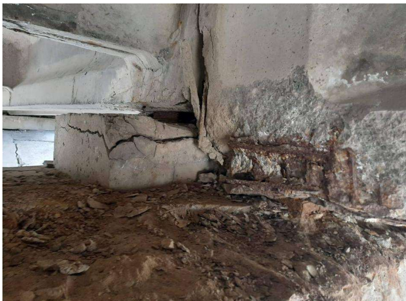
Рисунок 1 – Тріщини, сколи бетону з оголенням та корозією арматури в місці обпирання Figure 1 – Cracks, Concrete Spalling with Reinforcement Exposure and Corrosion at the Support Area
