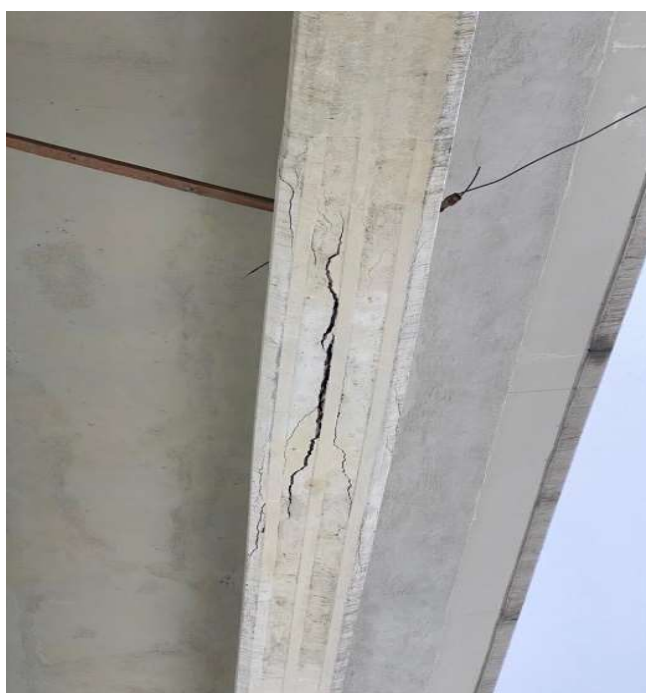
Рисунок 3 – Тріщини нижнього поясу Figure 3 – Cracks in the bottom chord
