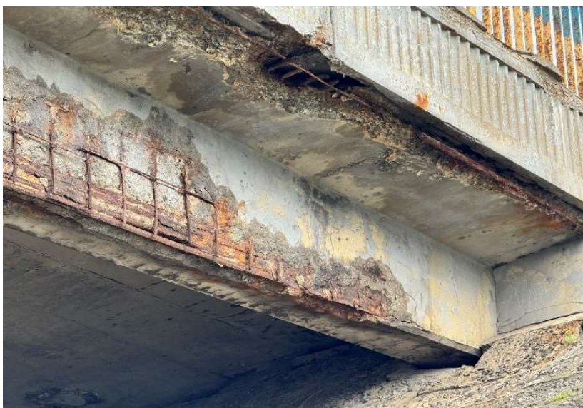
Рисунок 2 – Оголення і корозія арматури Figure 2 – Reinforcement Exposure and Corrosion
